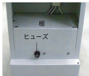
図17: 正面扉内部のヒューズと配線
